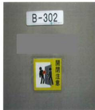
押し扉への 閉鎖注意シールの貼付
