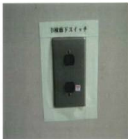
スイッチ周囲への蓄光テープ 貼付によるスイッチ場所提示
