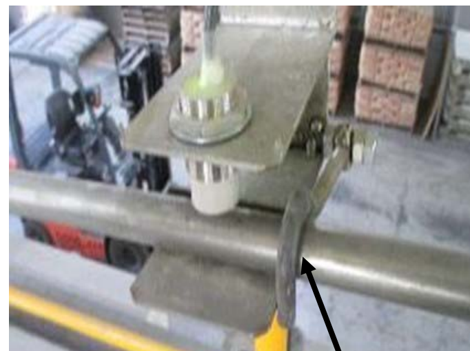
パイプ置き場にセンサー設置
