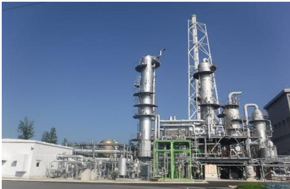
西火力3号機 炭酸ガス製造設備
