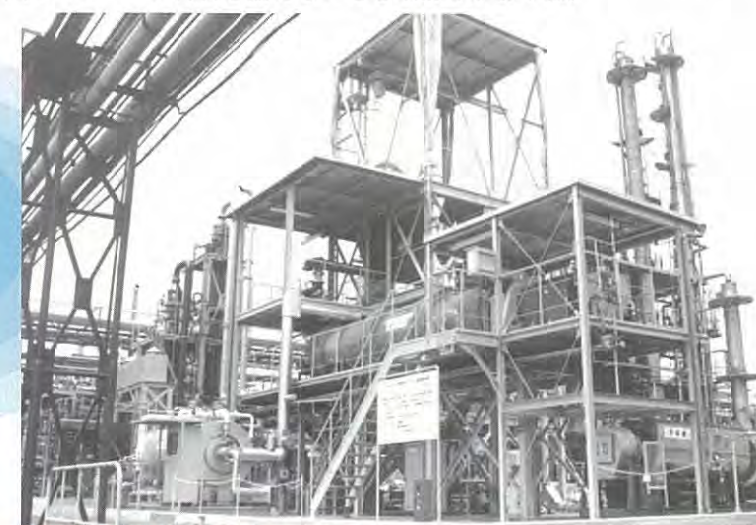
▲ 廃塩ビリサイクル実証プラント
