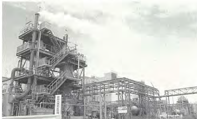
直江津工場に導入したリサイクルシステム設備 (煙突から出ているのは水蒸気です)
