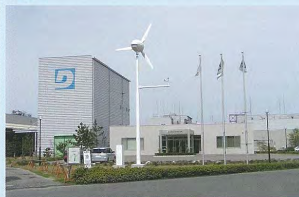
工場内の風力発電装置
