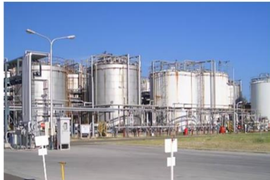
屋外貯蔵タンク
