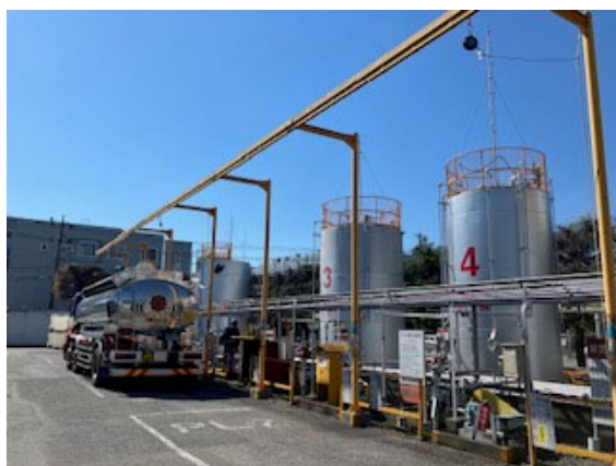
墜落防止設備
